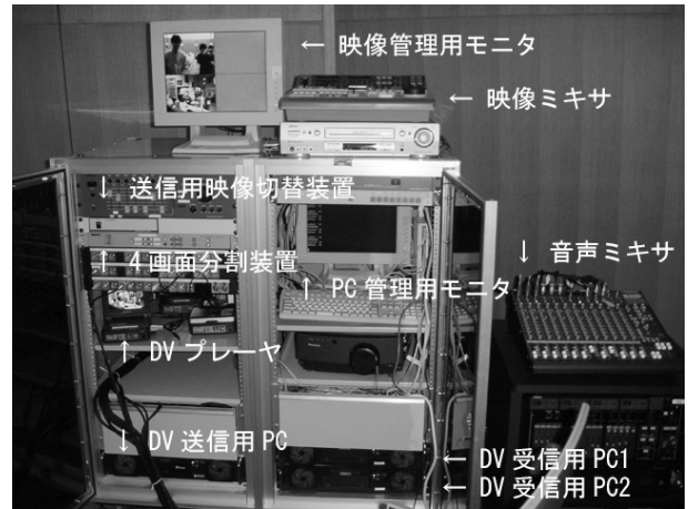
図-4 リアルタイムマルチメディア通信システムの外観
